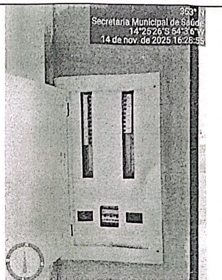
Figura 10 Quadro de energia interna do prédio
