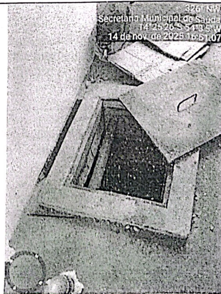
Figura 40 Cisterna de incêndio
