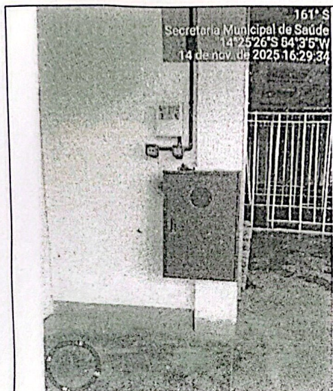
Figura 13 Abrido de hidrante piso térreo
